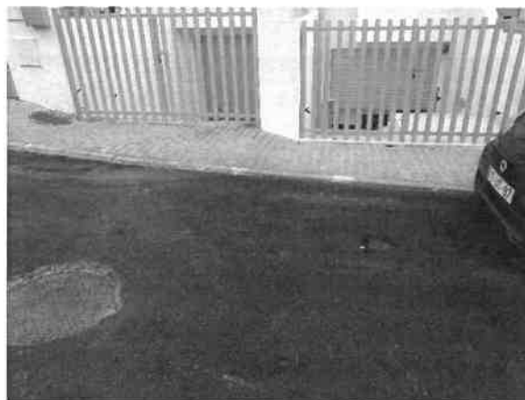
Foto 1- Tampas das caixas das infraestruturas desniveladas em relação ao tapete
