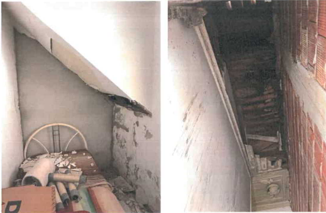
Figura 5 - Vão das escadas de acesso ao 1.º andar e estrutura do pavimento do 1.º andar visível do interior do rés-do-chão.
