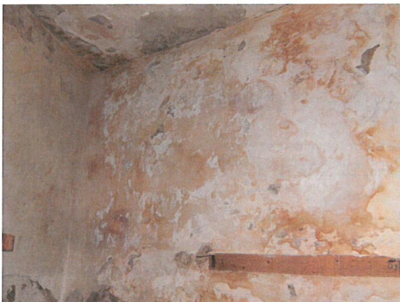
Foto n.º 2 – Interior da parede do piso em cave apresentando manchas de humidade
