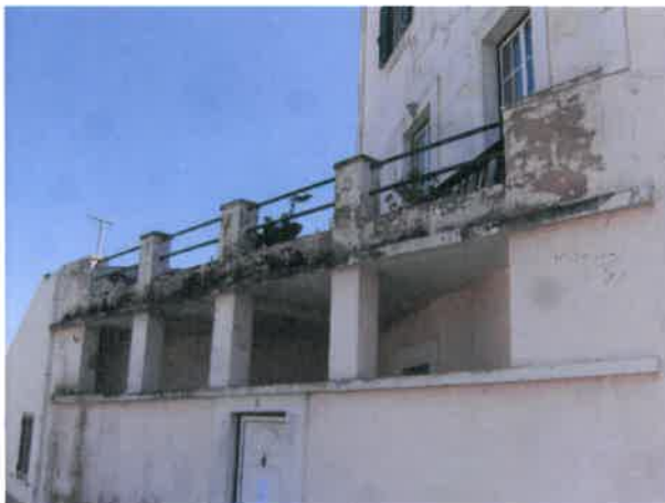
Foto n.º1 – Fachada com deficiente manutenção
