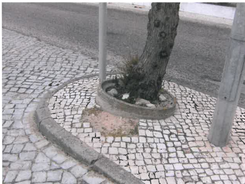
Foto n.º 3 - Passeio com ausência de calçada e caldeira da árvore
