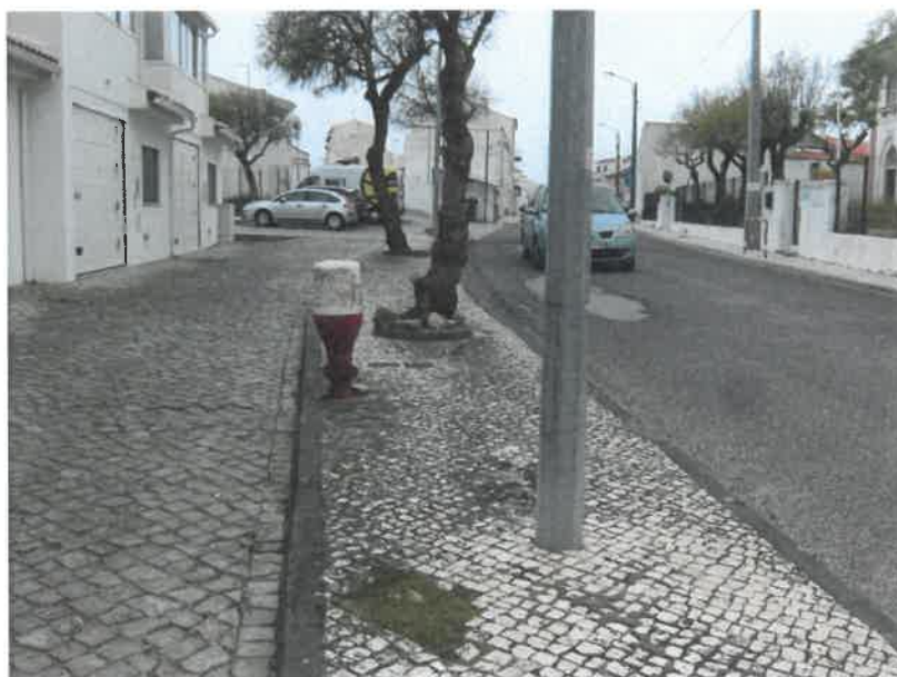
Foto n.º 2- Passeio com ausência de calçada
