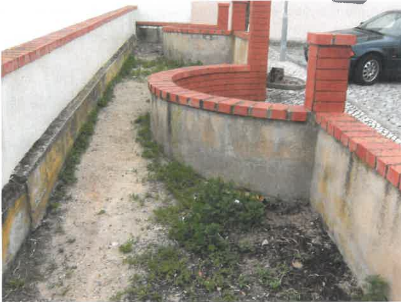
Foto n.º 4 - Ausência de tratamento do canteiro com acumulação de lixo
