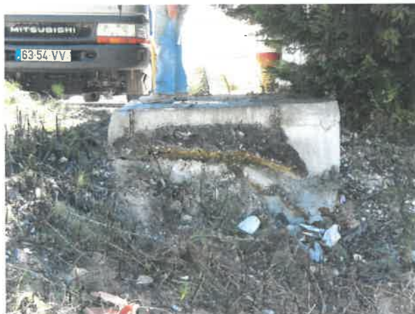
Foto n.º 3 – Falta de sustentação da base
