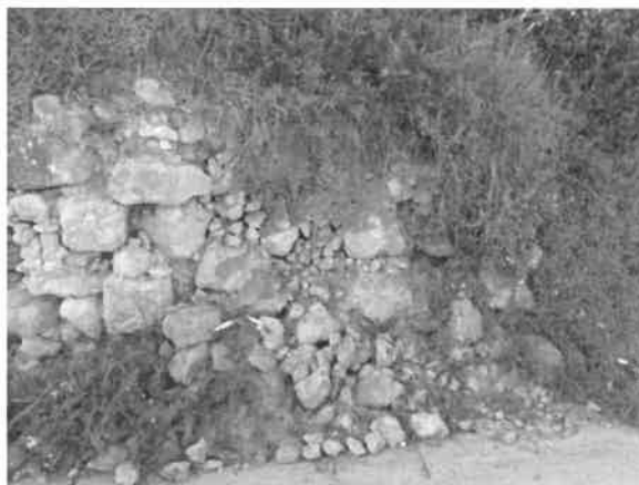
Foto n.º 1 – desmoronamento/ruína parcial
