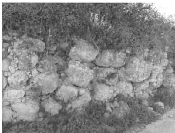
Foto n.º 2 – Em risco de desmoronamento
