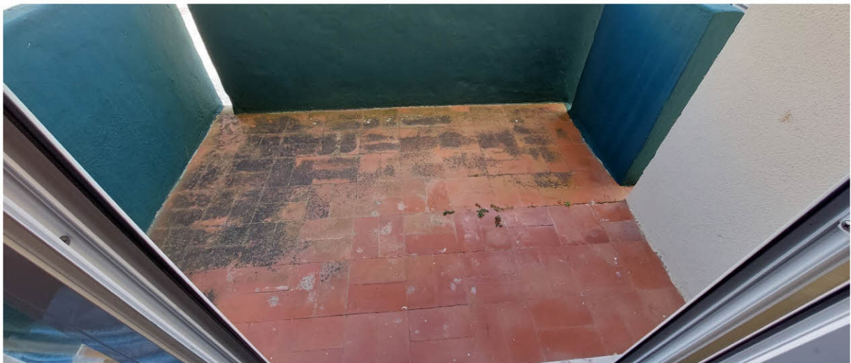
Figura 2.5 – Varanda do 1º andar da fração U com abertura de junta do revestimento, paralela à fachada, possivelmente associada a deformação
