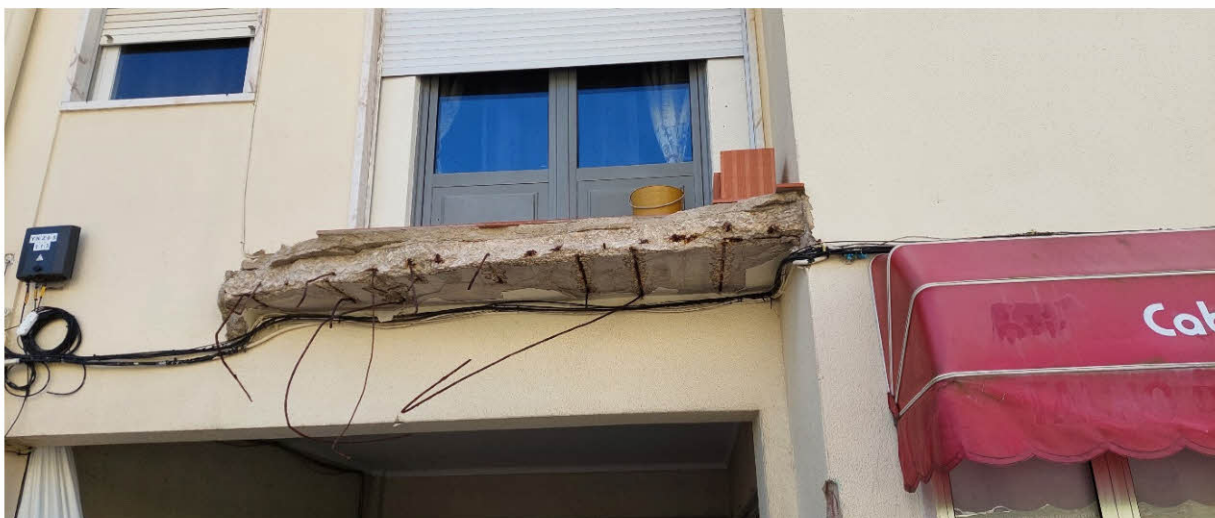
Figura 2.3 – Pormenor da zona onde ocorreu o colapso da varanda
