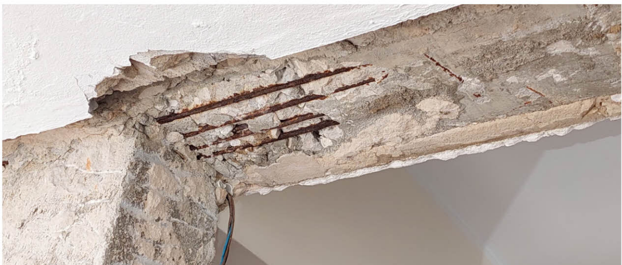
Figura 2.6 – Armaduras à vista e com corrosão numa viga sem reboco localizada na fração B
