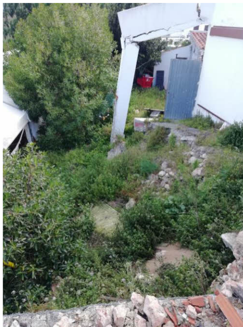
Foto n.º 2 – Muro de pedra emparelhada e pórtico em aparente colapso
