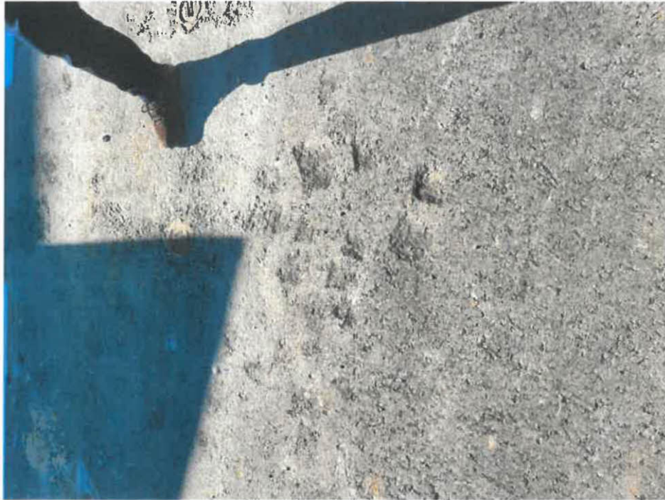
Foto 1 : irregularidades na estrutura do pavimento rodoviário
